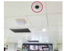
駅構内の防犯カメラ
