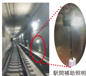
駅間補助照明
