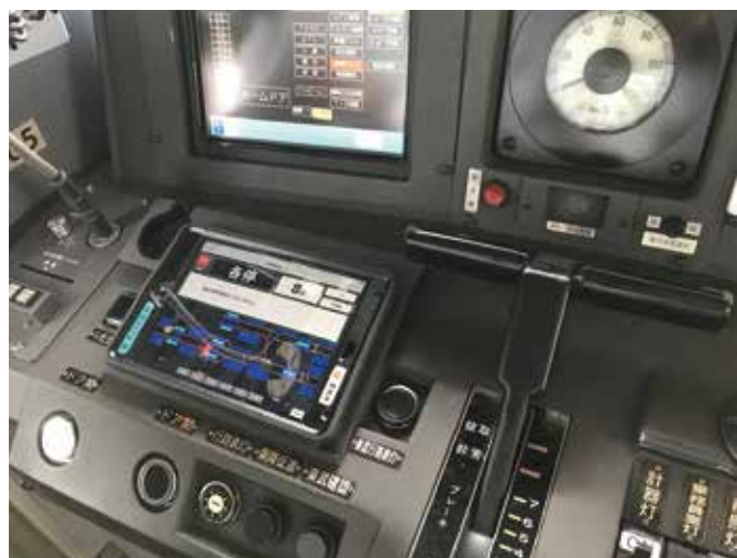
運転台には運転支援アプリを起動したタブレット端末を置いています
