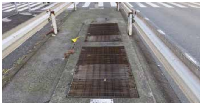
対策前の換気口
