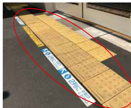
内方線付き 点状ブロック
