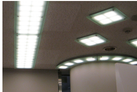
鉄道業界で初めて導入する次世代照明 [有機EL照明]
