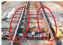
分岐器の電気融雪器 枕木上のヒーター(赤枠内)
