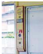
車内非常通報ボタン
